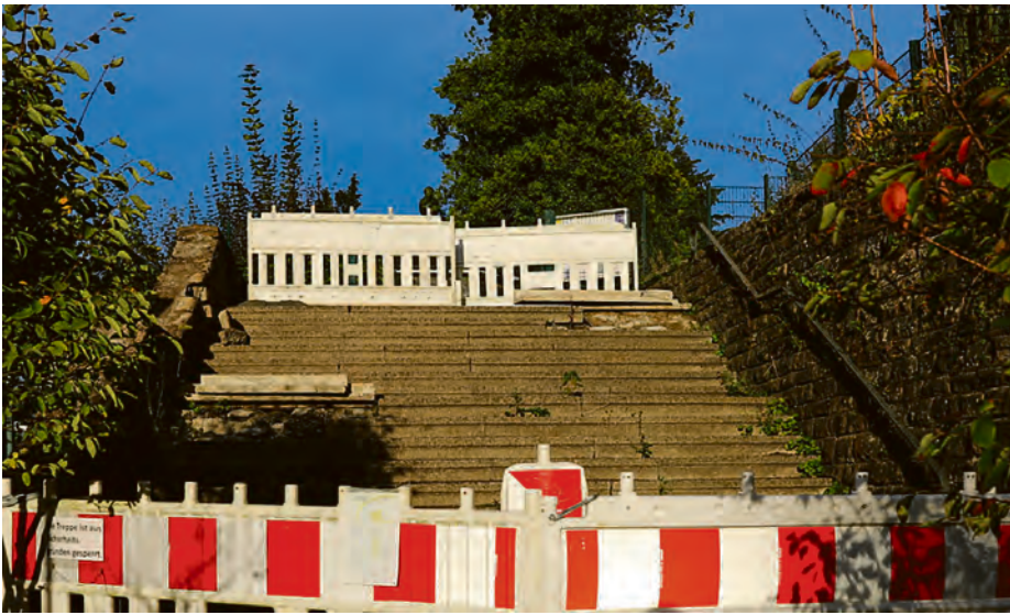
Die Treppe am Haupteingang ist seit Monaten nicht nutzbar. Foto: Volkmann
